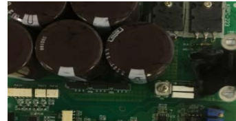
基板劣化による焼損
